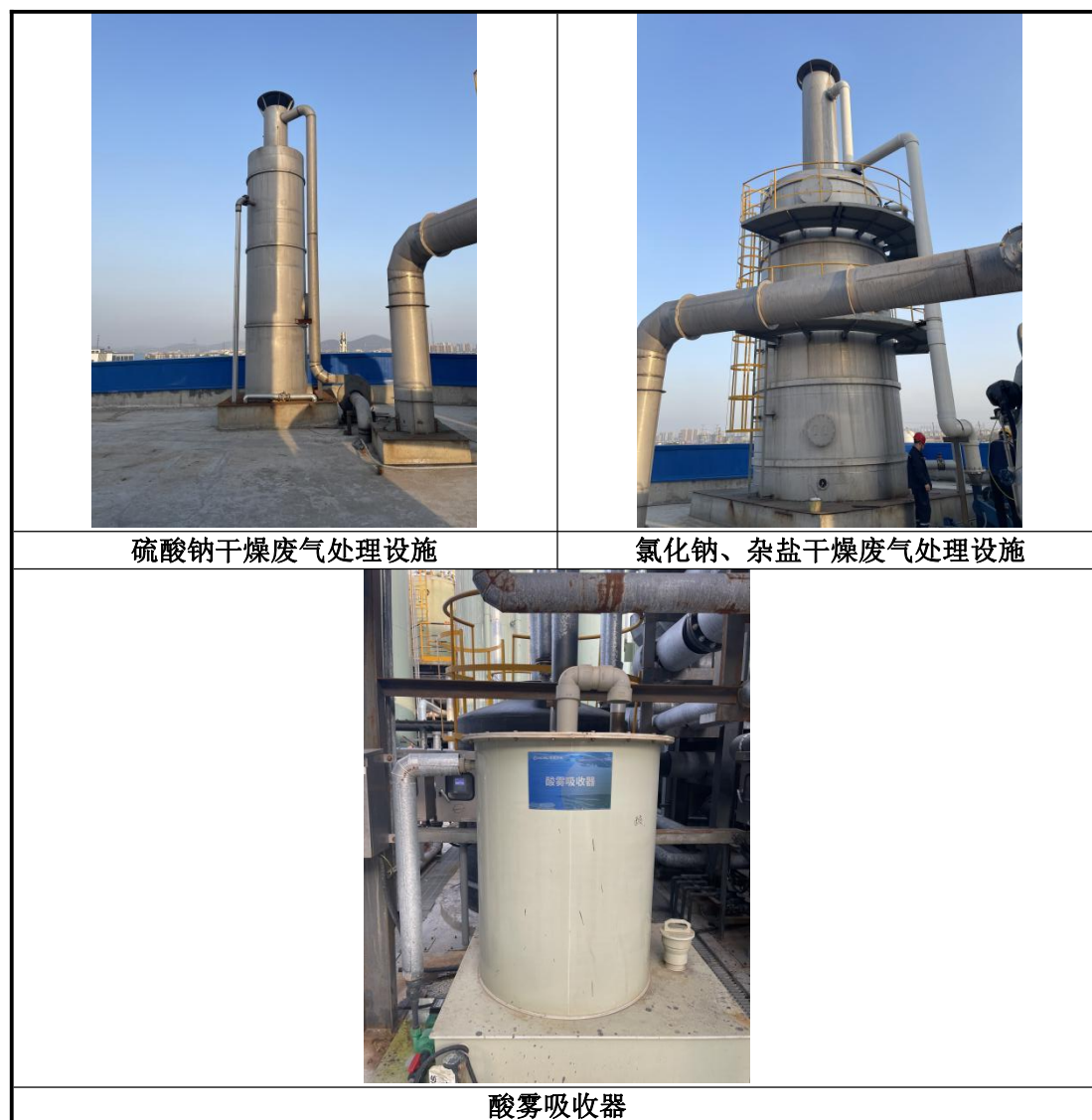
图 3-1 废气处理设施
