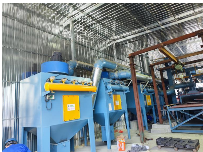
抛丸打磨除尘器
