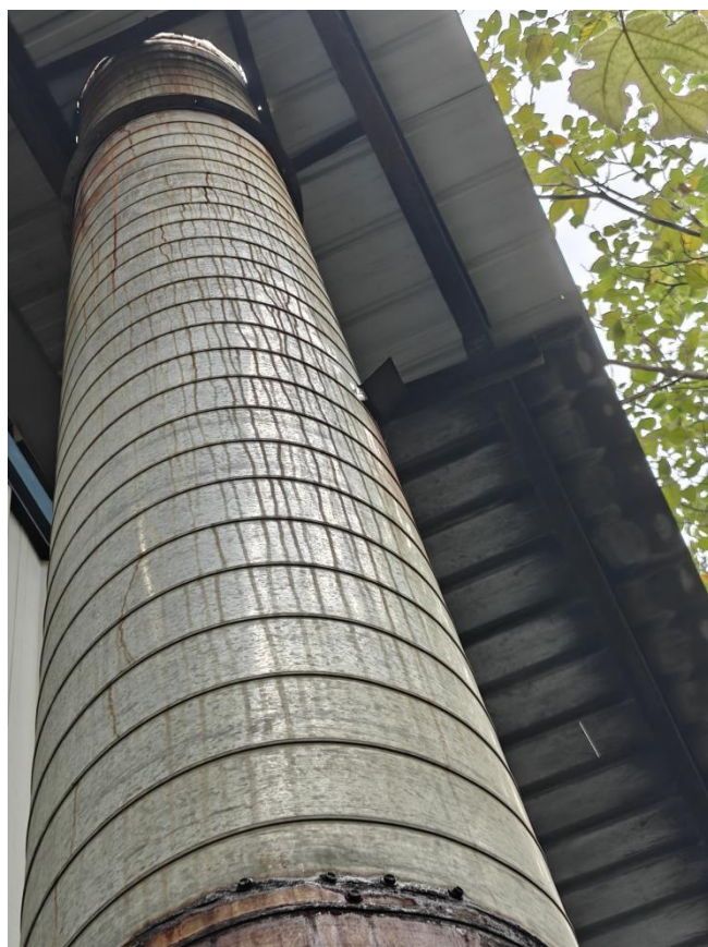
图4-1 淬火和天然气燃烧废气排放口（DA004）
