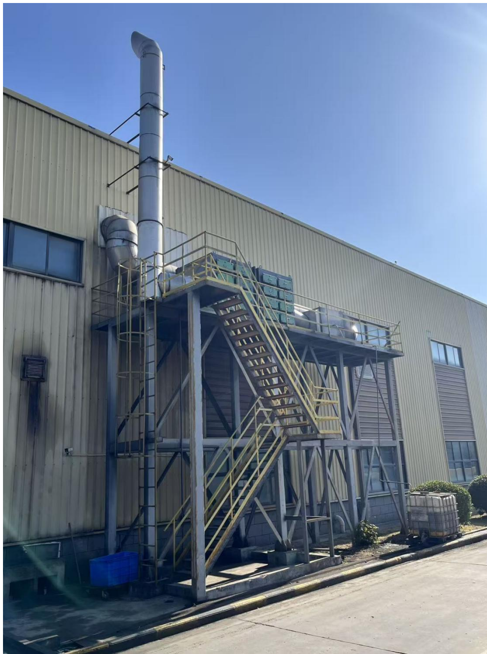
图3-2 热处理废气排放口（DA003）
